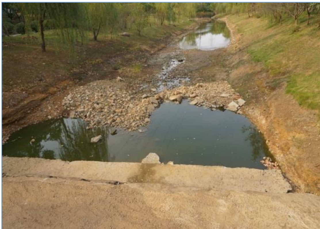
城南河湾石路下游溢流堰断流,堰坝漏水,局部存在冲刷
